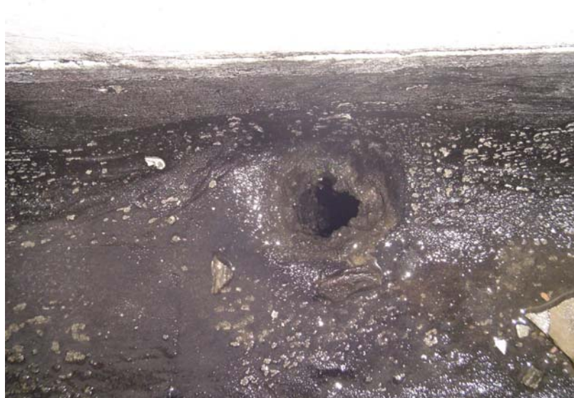
Figura 3.4 – Vista de um condutor vertical, de seção 100mm, tomado pela sujeira proveniente do tempo de uso
