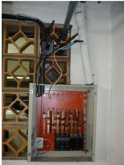
Figura 6. Medição do circuito de alimentação da lavadora de roupa.
