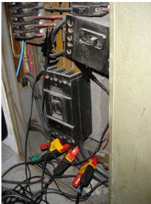
Figura 8. Medição do quadro geral de energia elétrica do hotel.
