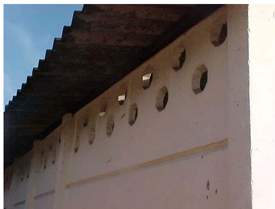
FIGURA 4.26 – Pequenas aberturas para renovação do ar interno.
