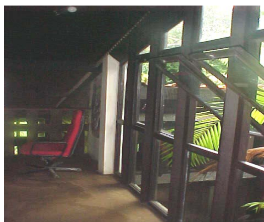
FIGURA 4.28 – Escolha por esquadrias em dimensões maiores e que favoreçam a ventilação e iluminação.
